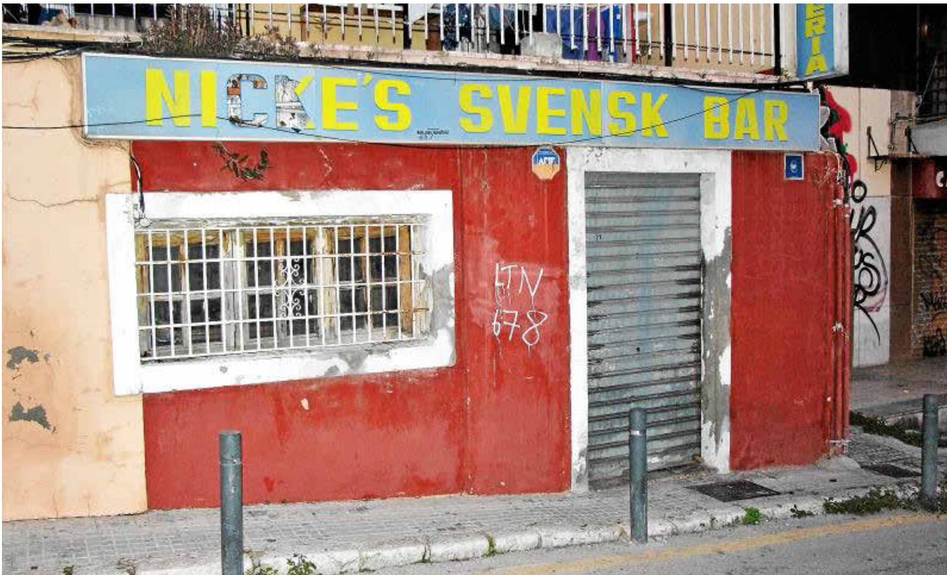
Noch sieht es rund um die Plaça Gomila häufig so aus: Von den Fassaden geschlossener Bars und Kneipen bröckelt der Putz. Fotos: M. Schulte
